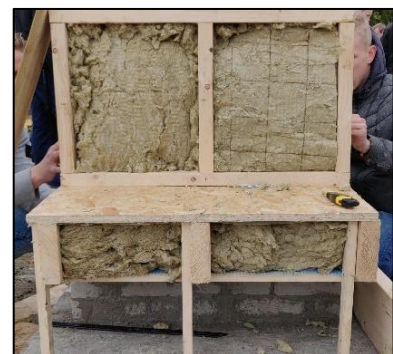
figuur 4.3.7 Geïsoleerde gevel met verkeerde isolatiemateriaal
