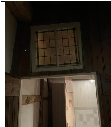
Foto 7 Raam boven wc
