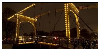
Figuur 24 Lampen op brug die de brug verlichten
